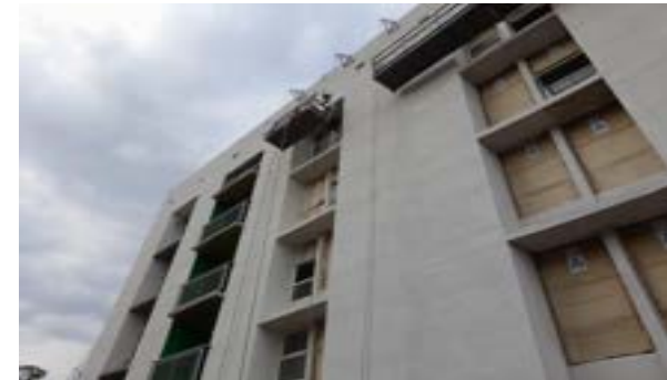
BLOCO E – Textura projetada na fachada
