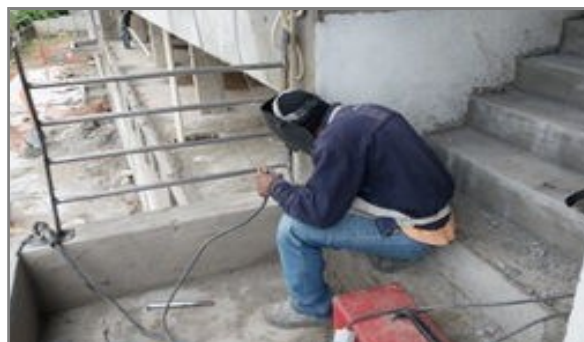
Condomínio 3 – Bloco 2,3 e 4 – Guarda corpo
